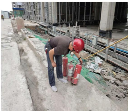
一线人员检查灭火器
